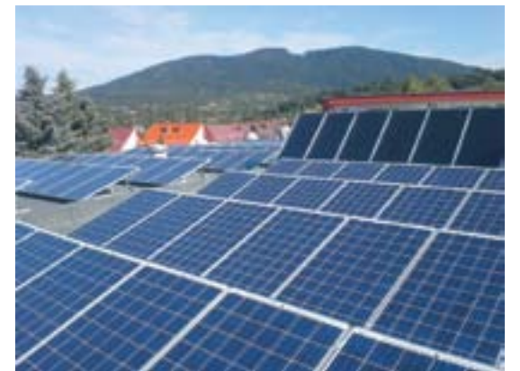
Napelemrendszer a Nemes János Általános Iskola és Alapfokú Művészeti Iskola épületén (Hosszúhetény)
